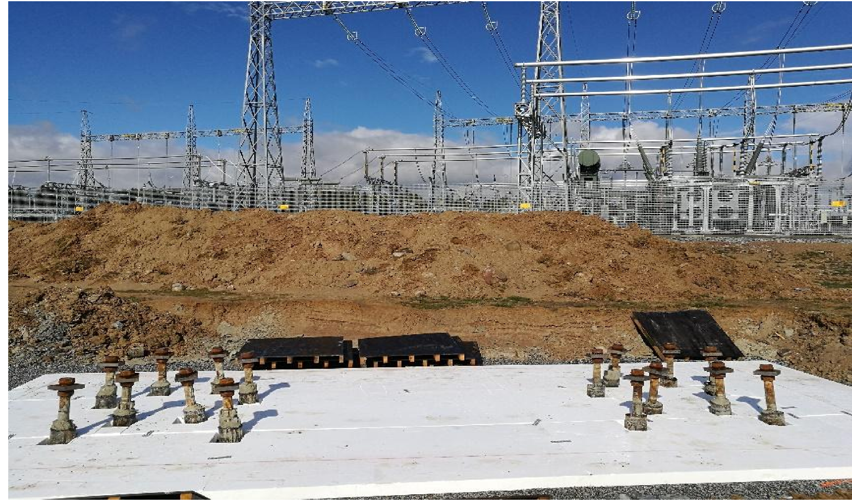
瑞典卡尔斯库加市高压输电塔桩基
