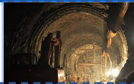
大盈江水电站引水隧洞塌方
