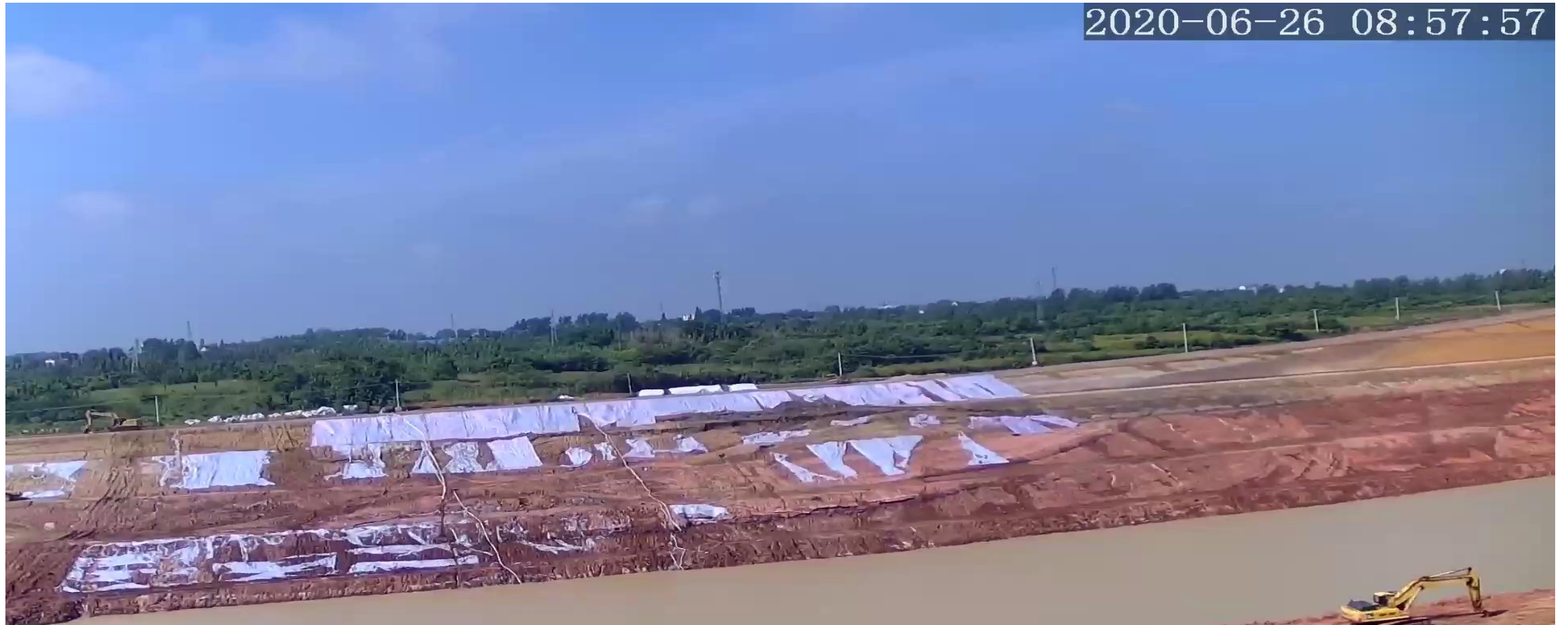
引江济淮工程膨胀土大型滑坡现场
