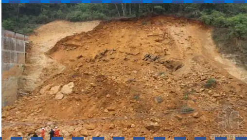
广西玉林市基坑垮塌
