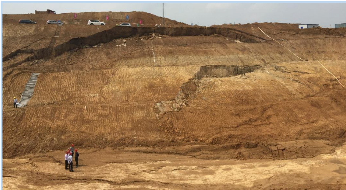
膨胀土深挖方边坡滑坡
