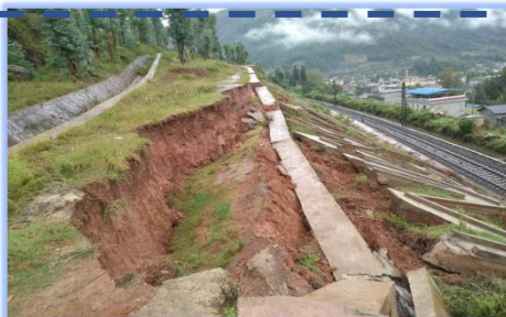
成昆铁路边坡滑坡
