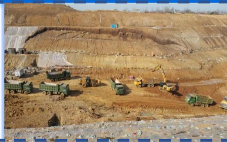
鄂北调水膨胀土渠道滑坡
