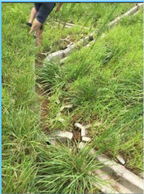
坡面隆起变形
