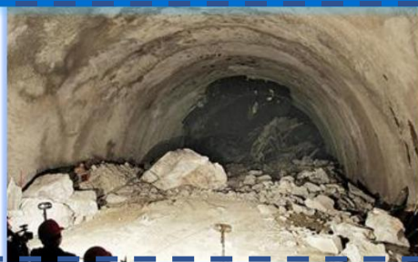
石武高铁木兰隧道塌方
